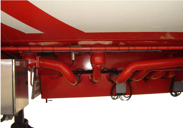
Válvulas de fondo y colectores salida/entrada producto
