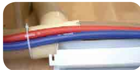
Tuberías de agua protegidas contra el hielo.
