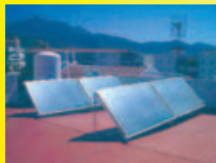
Instal·lació solar tèrmica
